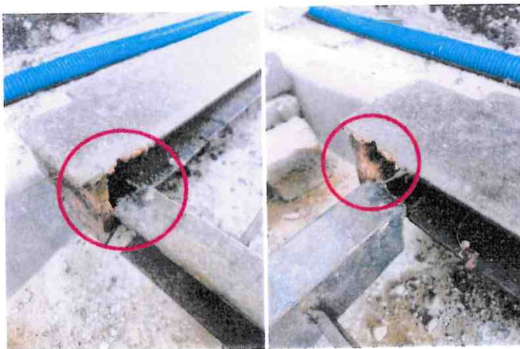
Fot. 1-2. Degradacja korozyjna konstrukcji skrzydła bramy - skrzydło, które uległo awarii i upadkowi.
