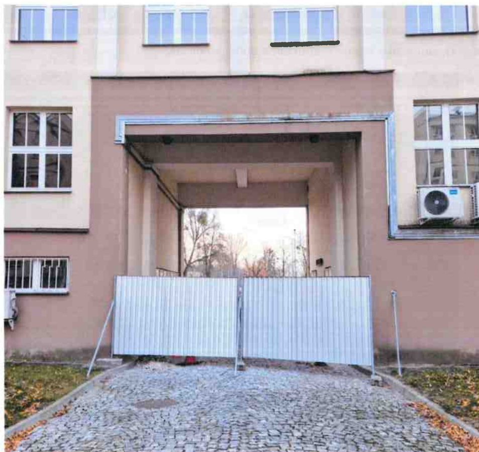
Fot. 3. Otwór montażowy bramy, która uległa awarii (widok od strony północnej)
