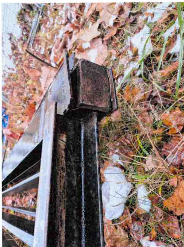
Fot. 8. Wybrany uszkodzony narożnik skrzydła bramy
