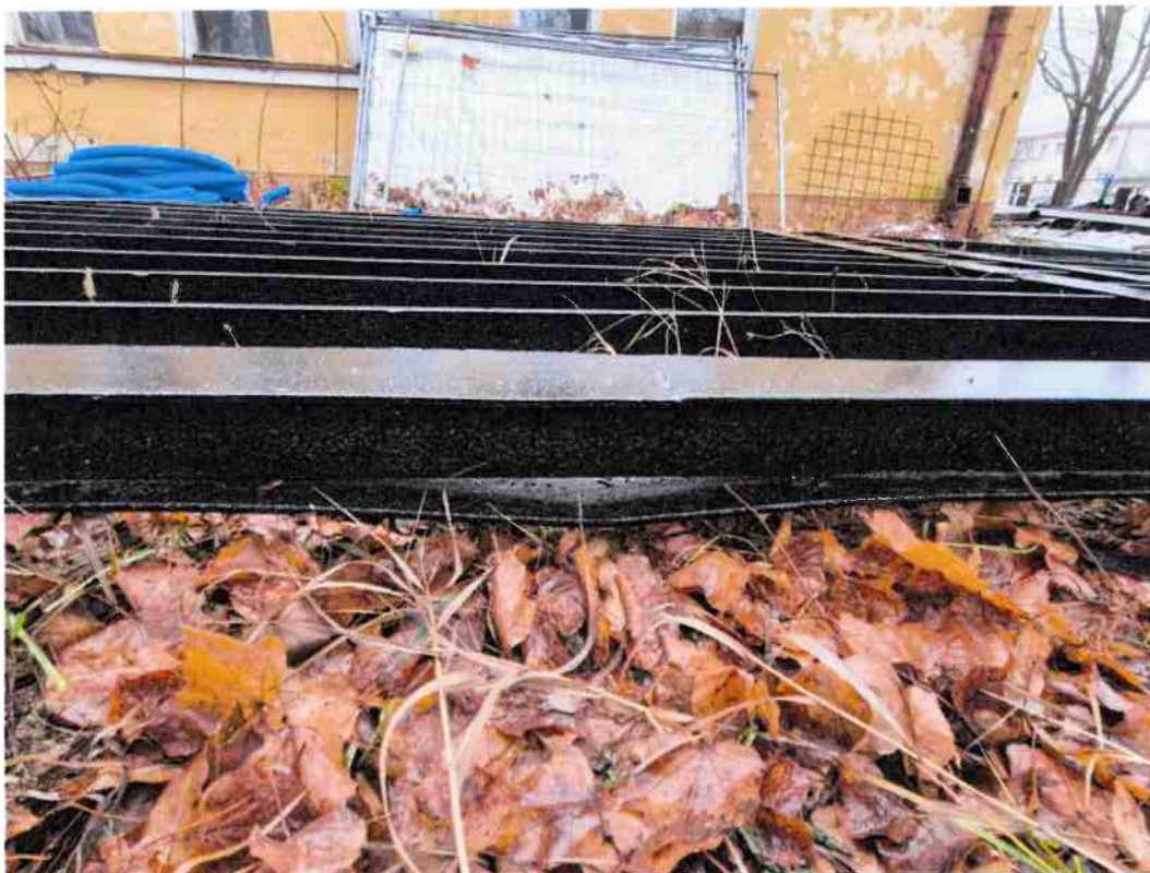
Fot. 11. Odształcenie profilu ramy skrzydła bramy
