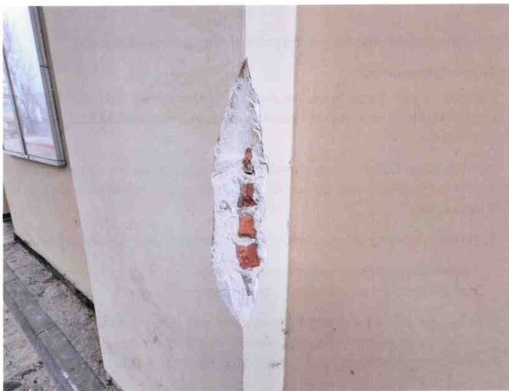
Fot. 12. Uszkodzony fragment elewacji w wyniku awarii bramy w podcieniu komunikacji na dziedziniec
