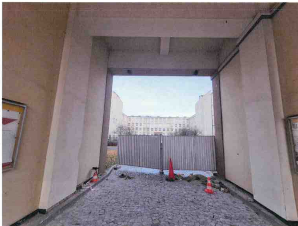
Fot. 2. Otwór montażowy bramy, która uległa awarii (widok od strony południowej)
