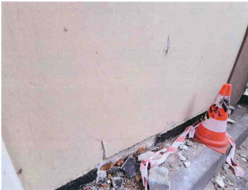
Fot. 13. Uszkodzony fragment elewacji w wyniku awarii bramy w podcieniu komunikacji na dziedzińcu
