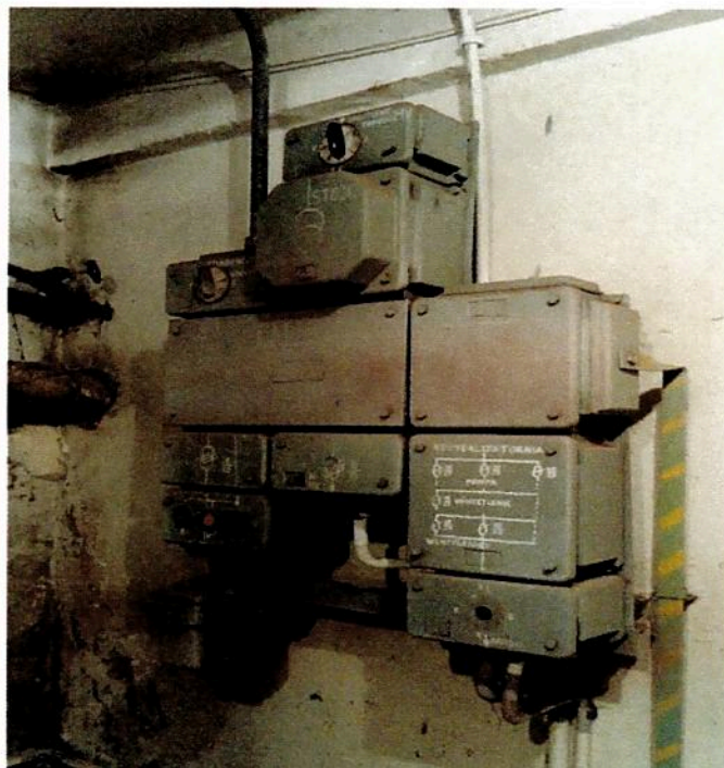
Rys. 5 – Instalacja elektryczna: rozdzielnia windy w maszynowni
