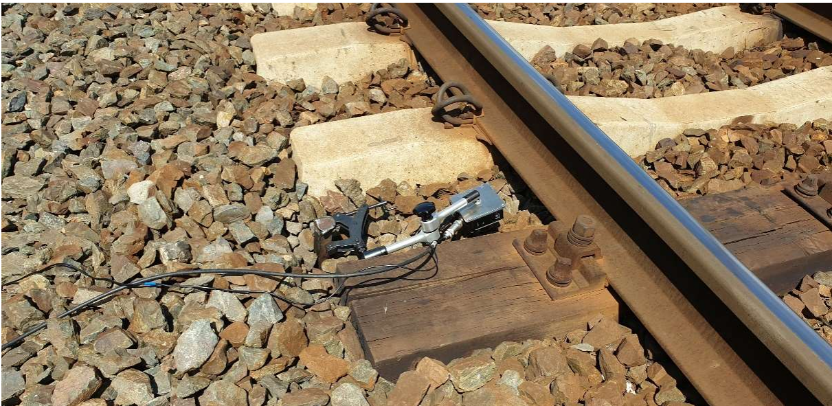
Rys. 4.10 Stanowisko pomiarowe – skokowa zmiana sztywności nawierzchni – dojazd do wiaduktu kolejowego w km 88,882 LK nr 272 – fotografia własna.
