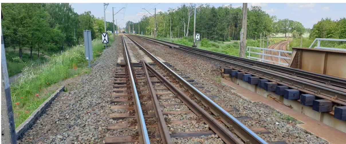
Rys. 4.19 Nawierzchnia przed wiaduktem kolejowym w km 83,808 LK nr 272 – fotografia własna.
