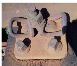
Rys. 1.24 Przytwierdzenie SKL12 – fot. własna.
