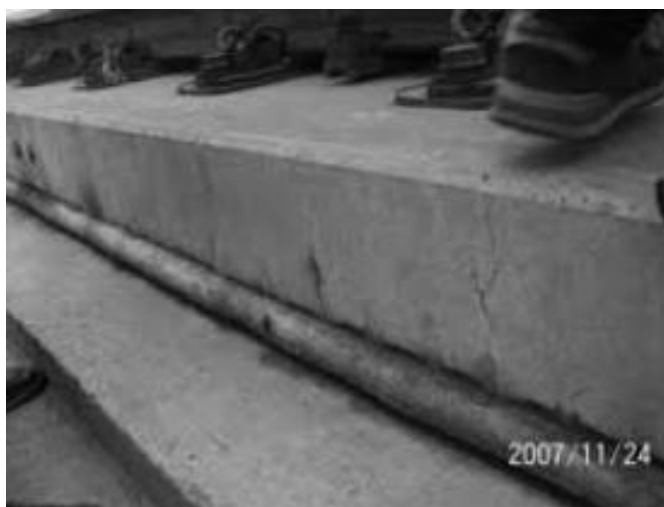
Fot. 1.8. Zarysowania nawierzchni [68]
