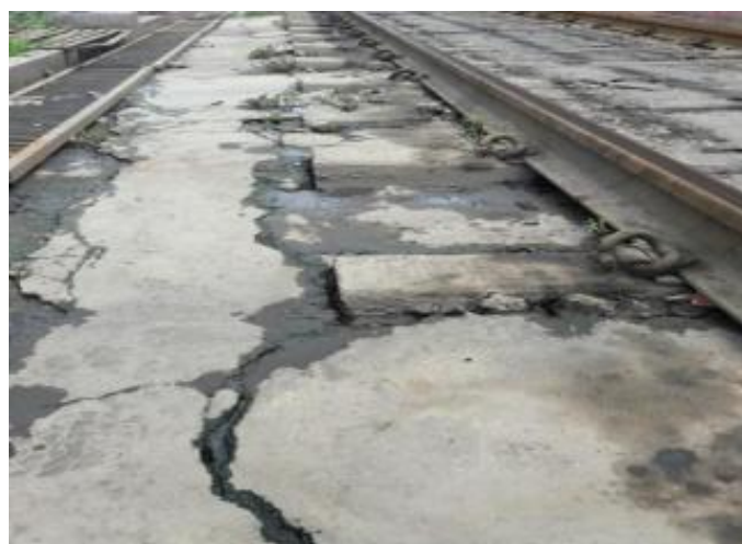
Fot. 1.3. Uszkodzenia nawierzchni przy czołach podkładów [8]
