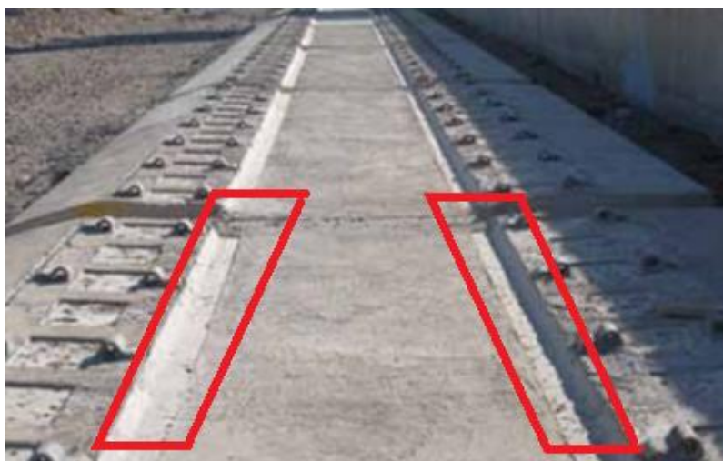
Fot. 1.6. Uszkodzenia nawierzchni prefabrykowanej [2]
