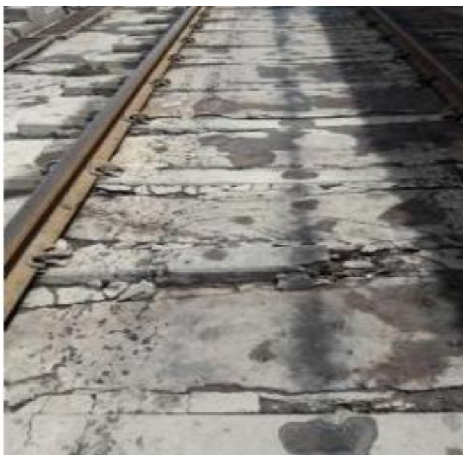
Fot. 1.2. Pęknięcia poprzeczne nawierzchni [8]
