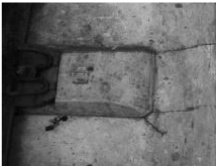
Fot. 1.4. Uszkodzenie płyty torowej przy podporze blokowej [24]
